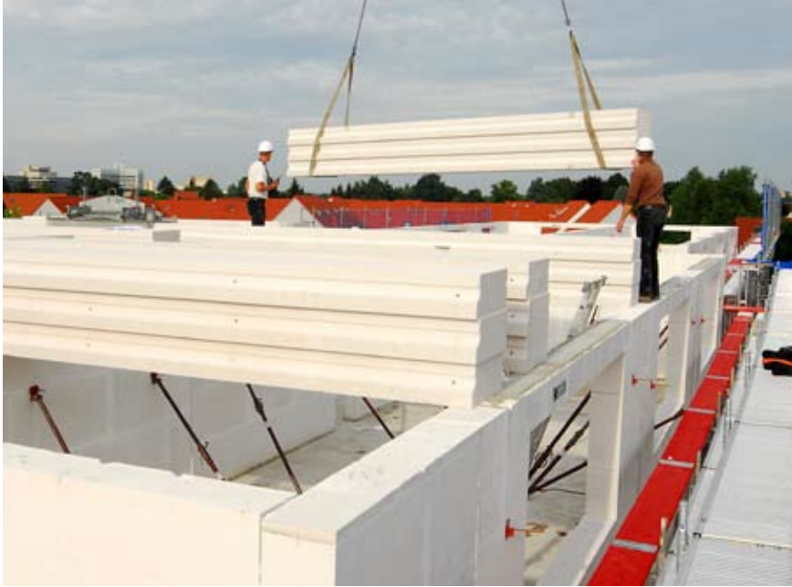
Das Gebäudedach wurde als Massivdach mit Ytong Dachplatten ausgeführt und sorgte so für eine weitere Beschleunigung des Bauablaufs.
